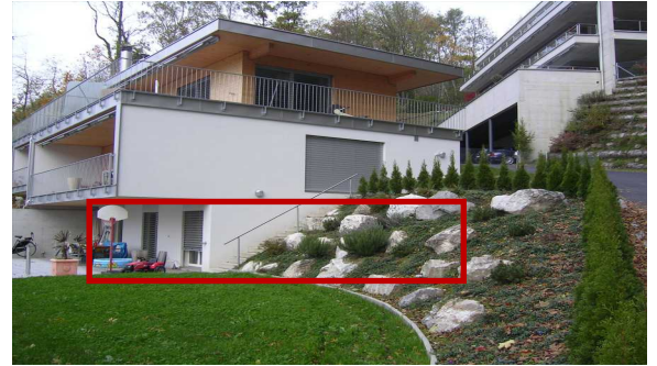
Wohnung erdberührt mit Riss in Betonwand.
