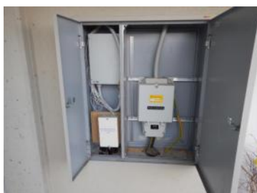
Wasser führende Versorgungs-Leitungen sorgen für sporadischen Wassereintritt
