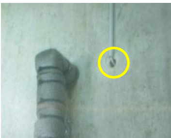
Verkleidete Wand, Erdreich berührt mit Leitungsdurchführung, führt zu rätselhaften Wasserschäden
