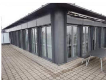
Fenster und Türen in der Gebäudehülle sowie Flachdächer sind in der Regel dicht, aber.....
