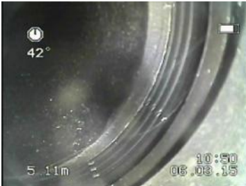
Ablaufrohr im Beton undicht
